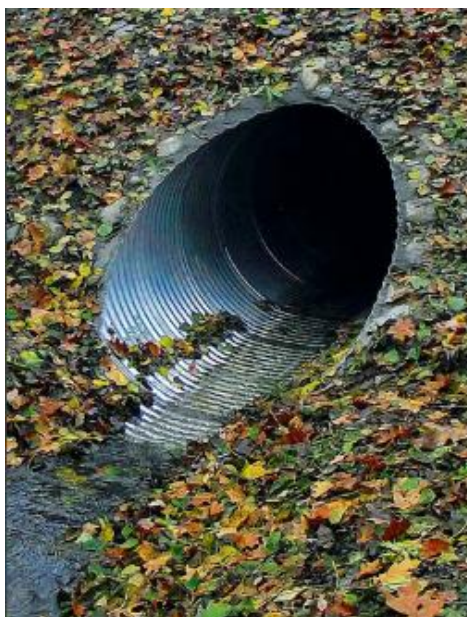
2 pav. Metalinės pralaidos vamzdis
