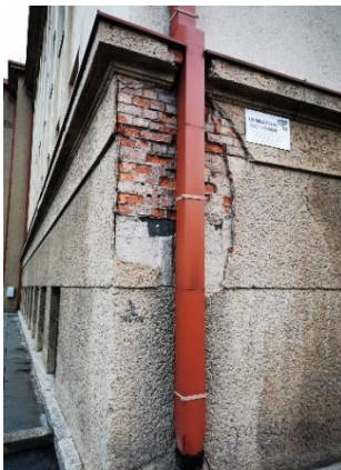
16 pav. Rytinio pastato fasado cokolinės dalies detalė 2010 m.
