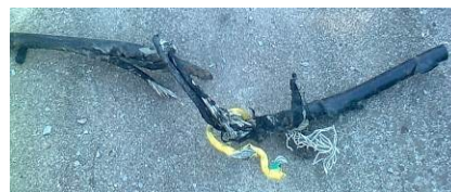
1 pav. Kabelių su XLPE pažeidimai
