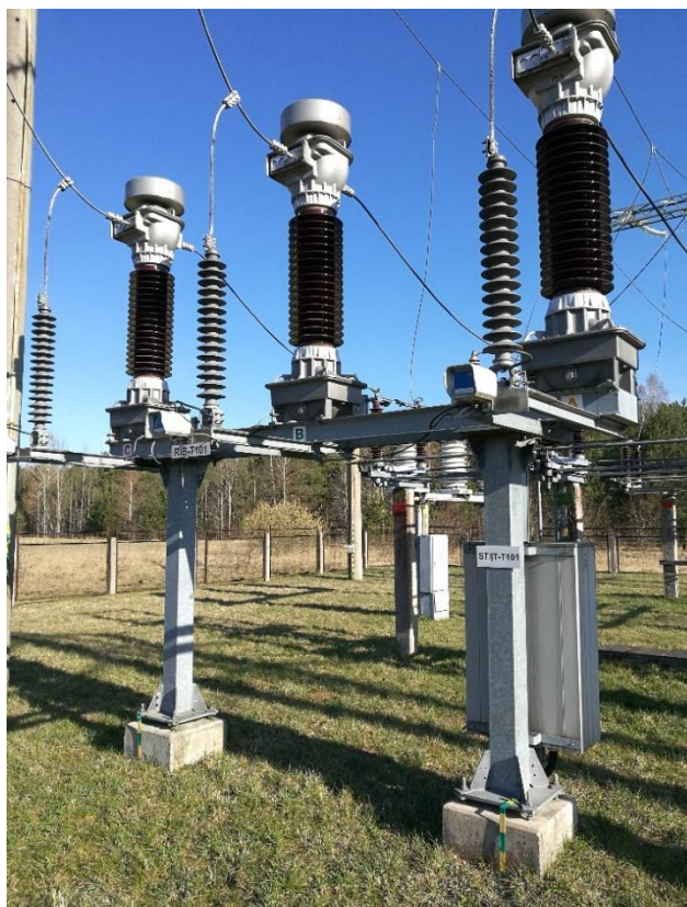
1 pav. Tiriamas objektas: srovės ir įtampos transformatorius
